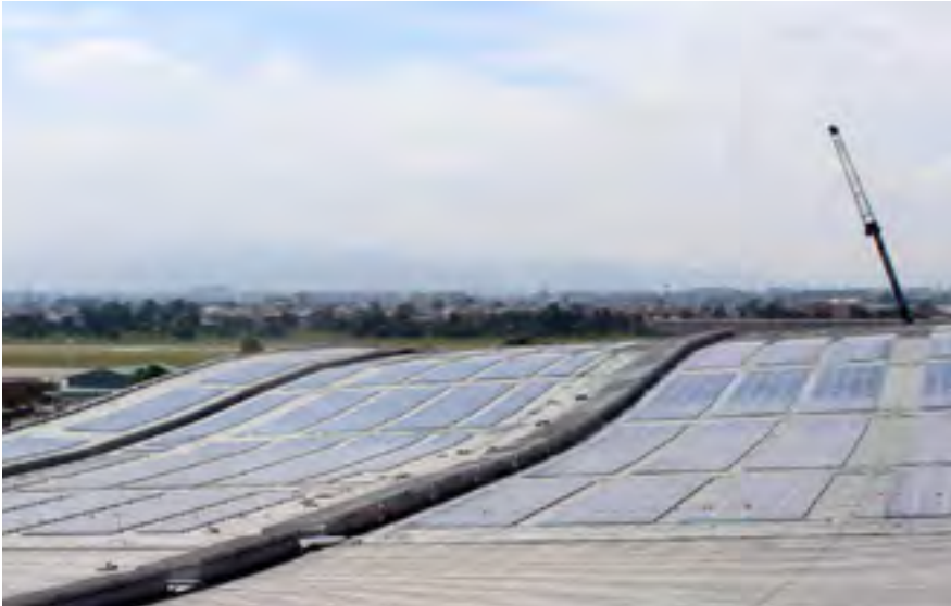
Paneles solares Aeropuerto El Dorado.
